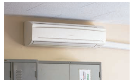
クラブ室内に設置されたエアコン室内機。
